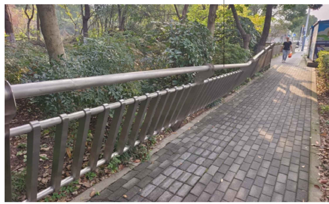
垃圾房北侧栏杆损坏
